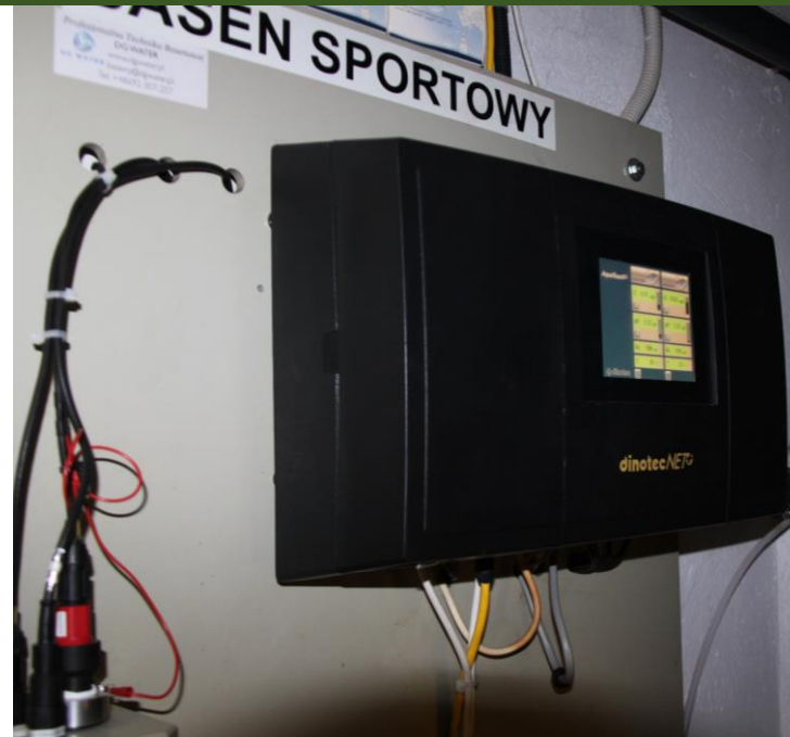
DOSTAWA I MONTAŻ STACJI KONTROLNO-POMIAROWEJ DLA DWÓCH NIEZALEŻNYCH OBIEGÓW WODY NA KRYTEJ PŁYWALNI
